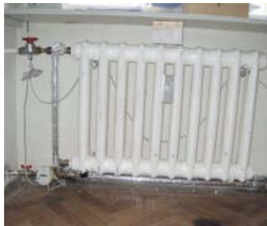
Abb. 12: Zwei Radiatoren im Raum wurden parallel geschaltet und mittels Wärmemengenzähler wurde ihr Gesamtverbrauch ermittelt.
