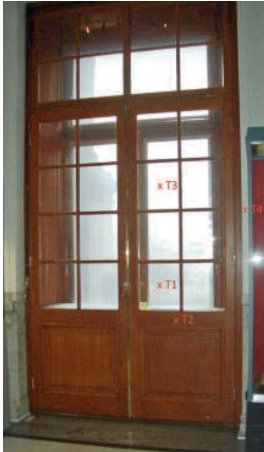
Abb. 8: Türelement auf dem Jagdplateau der Hofjagd- und Rüstkammer mit der Anordnung der Thermoelemente.
