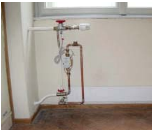
Abb. 11 b: Die Sockelheizleiste ist an die vorhandene Vorlauf- und Rücklaufleitung des Wärmeverteilsystems angeschlossen. Der Wärmeverbrauch kann über einen Wärmemengenzähler abgelesen werden.
