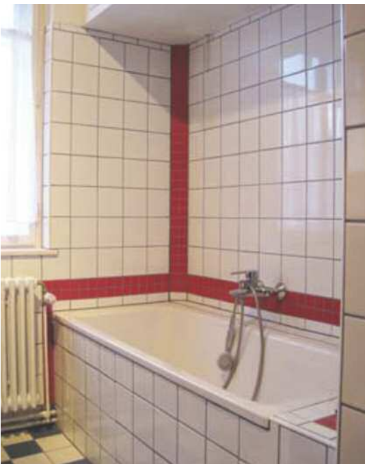
Der in der Außenwanddecke montierte Linear-Heizkörper sowie die an den Badewannenrand geführte Vorlauf-Leitung erhöhen das Strahlungsfeld der Badewannen-Nische. Der Röhrenradiator ist nur im unmittelbaren Bereich des Ventils aktiv
